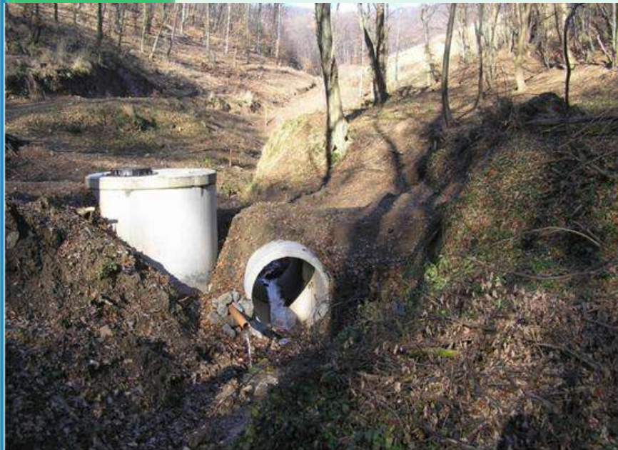
Seepage from WR (Frici- táró, ~40 m 3 /d)
